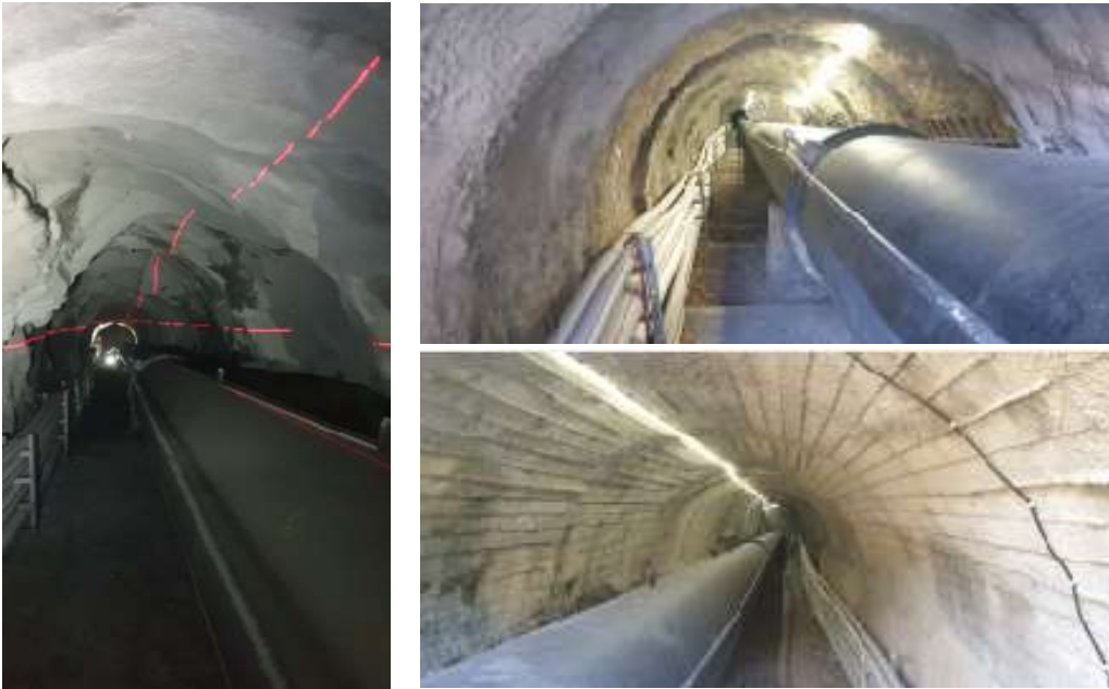
Abbildung 9: Beleuchtung in den Stollen Wolfsgrube und Dude
