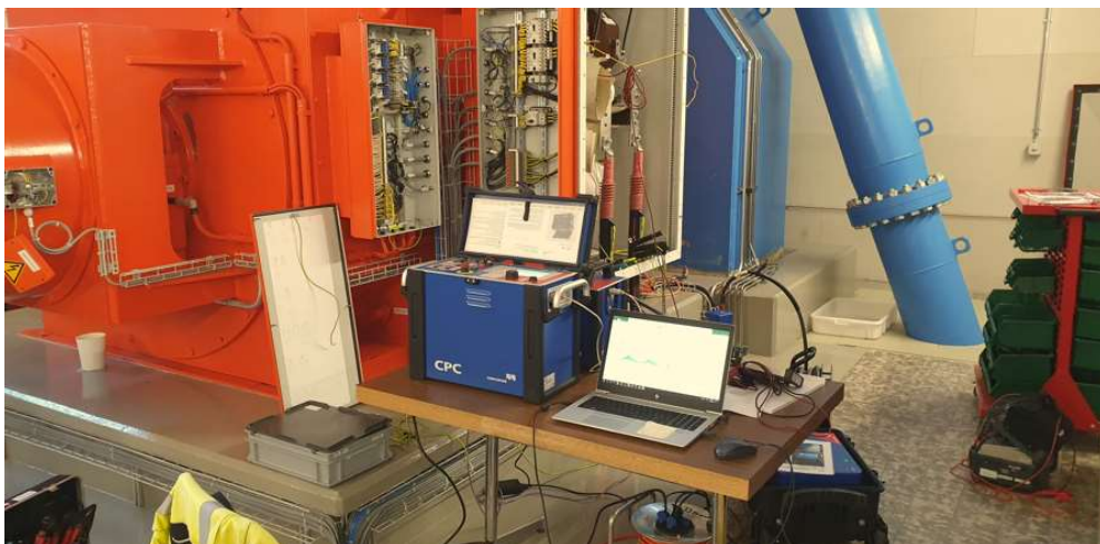
Abbildung 14: Messanlage Teilentladungsmessung der Generatoren.
