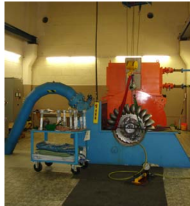
Abbildung 6: Abnutzungserscheinungen am Turbinenrad
