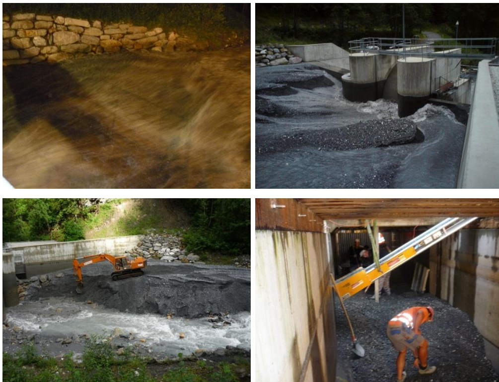
Abbildung 6: Auswirkungen des Hochwasserereignisses vom 24./25. Juli 2010.
