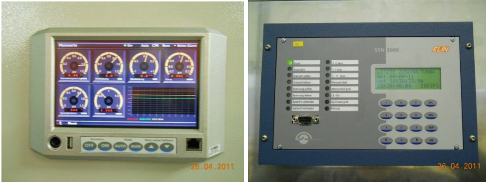
Abbildung 11: Neue Komponenten für die Synchronisation und Erregung der Maschinengruppe.
