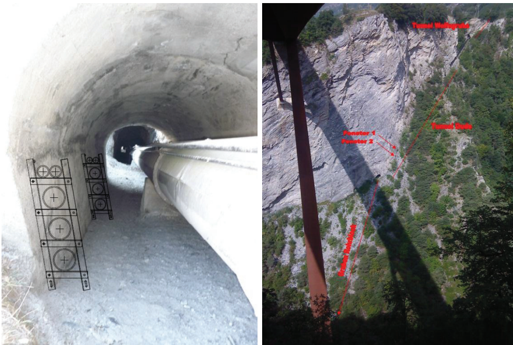
Abbildung 9: Zu sanierende Stollenabschnitte im Bereich Duden-Zentrale.
