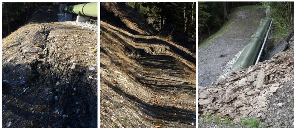
Abbildung 10: Bodensetzungen + Rutschung entlang der Hangleitung.
