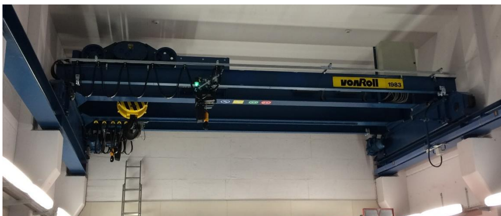
Abbildung 7: Erneuerte Krananlage mit zwei mobilen Katzen an den seitlichen Enden.
