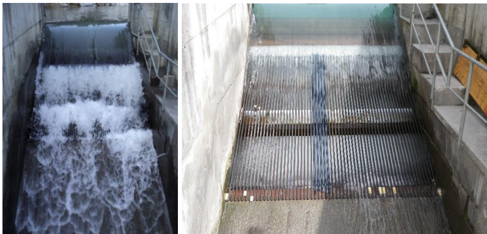
Abbildung 6: Links altes / rechts neues Tirolerwehr bei gleichem Abfluss von 2'400 l/s.
